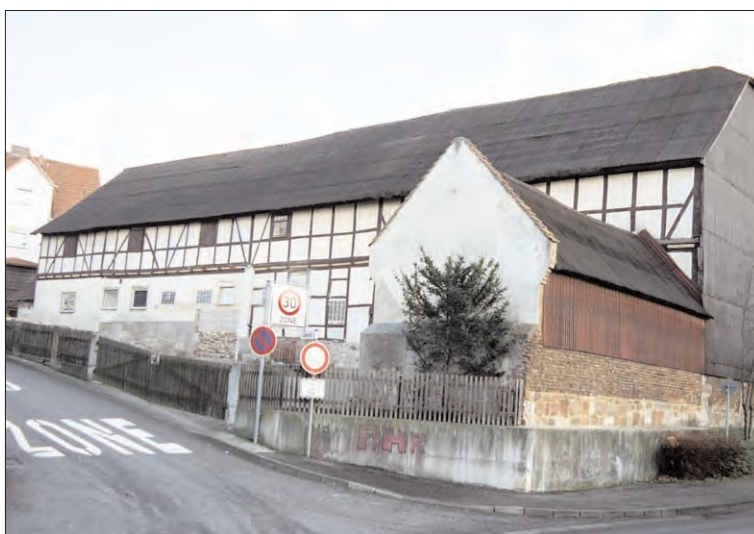
Dacheindeckung mit gewellter Teerpappe: nicht förderfähig
