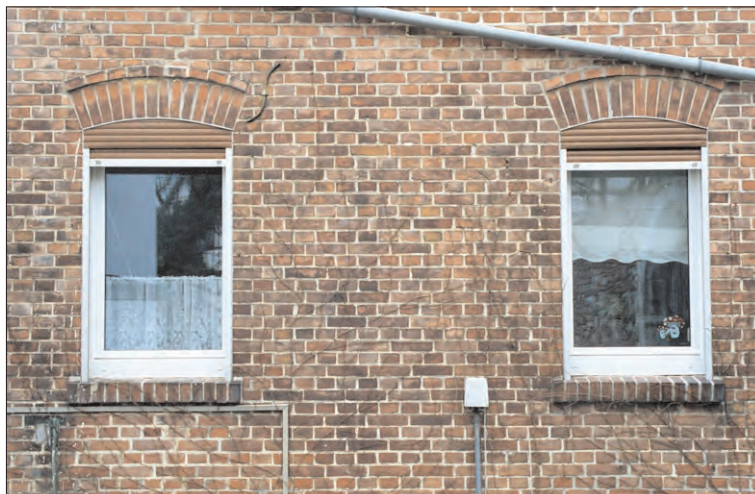
Veränderung der ursprünglichen Fensteröffnungen und Einbau von Rollläden: nicht förderfähig
