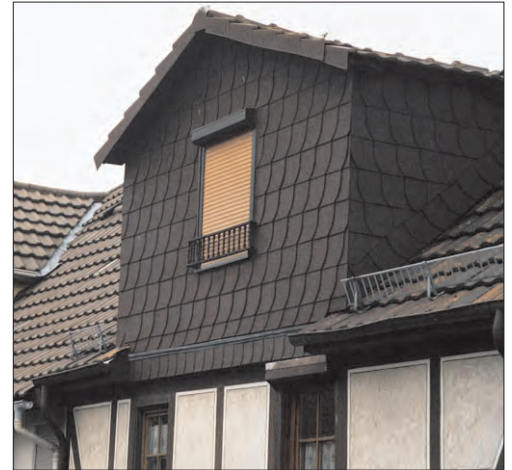
Dacheindeckung mit dunkelbraun engobierten Tonziegeln: nicht förderfähig
