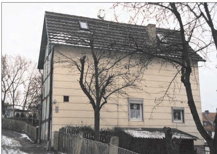
Verkleidung von Fachwerkfassaden mit Asbestschindeln: nicht förderfähig
