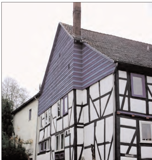
Verkleidung mit farblich auffälliger waagerechter Holzschalung: nicht förderfähig
