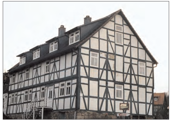
Dachfläche zwischen den Gauben nicht mehr wirksam: nicht förderfähig
