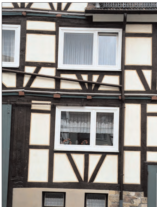
Nicht in die Konstruktion eingebundene Fenster: nicht förderfähig
