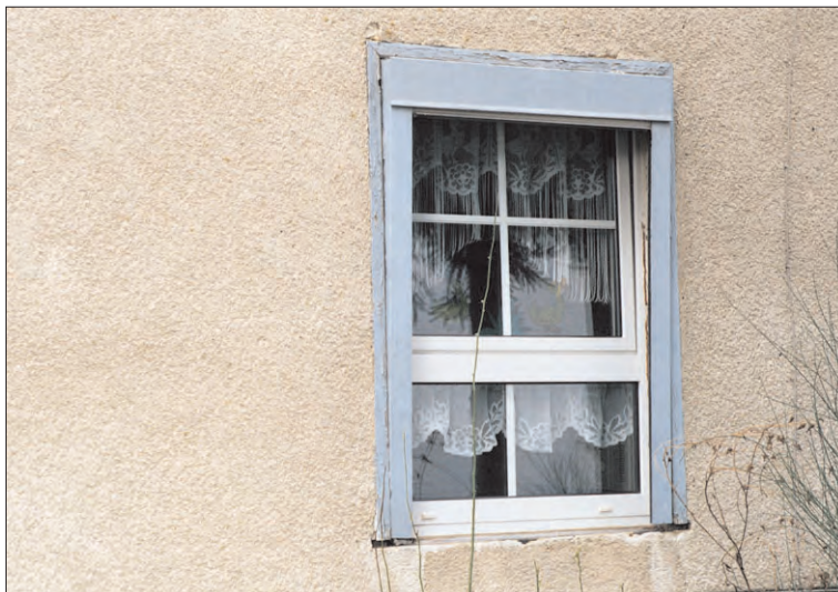
Kunststoff-Fenster mit „eingelegten“ Sprossen und Rollladenkasten: nicht förderfähig
