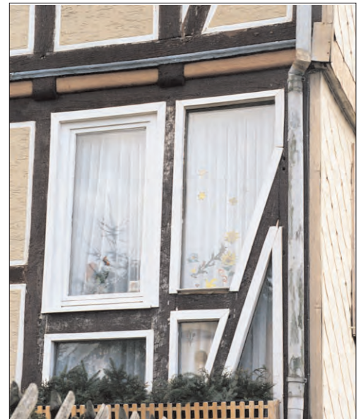
Ungeteilte Einscheibenfenster und verglaste Eckgefache: nicht förderfähig
