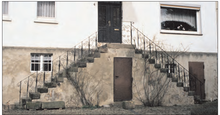
Historische doppelläufige Treppe mit schmiedeeisernem Geländer erhalten und instandsetzen: förderfähig
