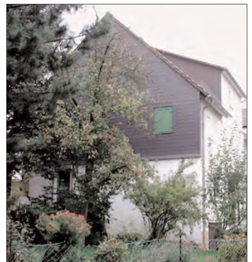
Verkleidung von Fachwerkfassaden mit Kunstschiefer: nicht förderfähig
