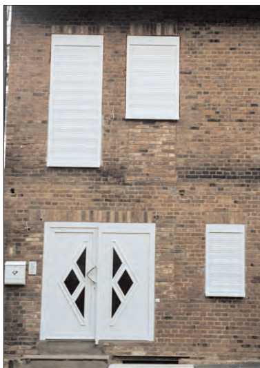
Unterschiedliche Öffnungen = unausgewogenes Fassadenbild: nicht förderfähig
