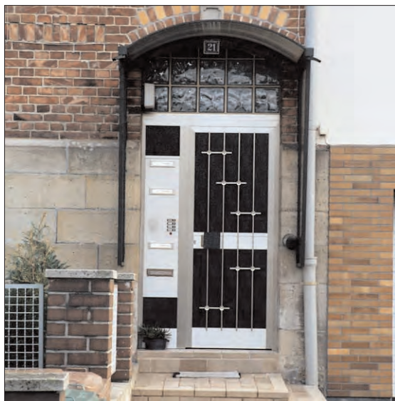
Einbau von Metalltüren und Veränderungen der ursprünglichen Türöffnung in historischen Gebäuden: nicht förderfähig
